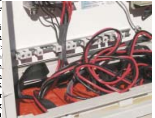
De UPS met onderaan een stel batterijen, als de gassen niet wegkunnen; kleine bommetjes.
