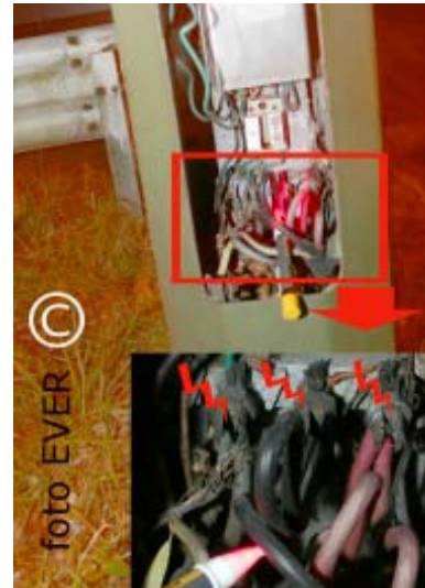
De 3 fasen staan onder spanning en zijn gewoonweg genaakbaar en dat is strijdig met art. 29 en 34 van het AREI.
