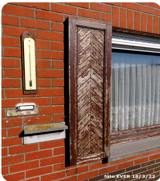
Te huur aangeboden via SVK Meetjesland / Eeklo ... over de rest van de staat van dit pand is het laatste nog niet gezegd.
