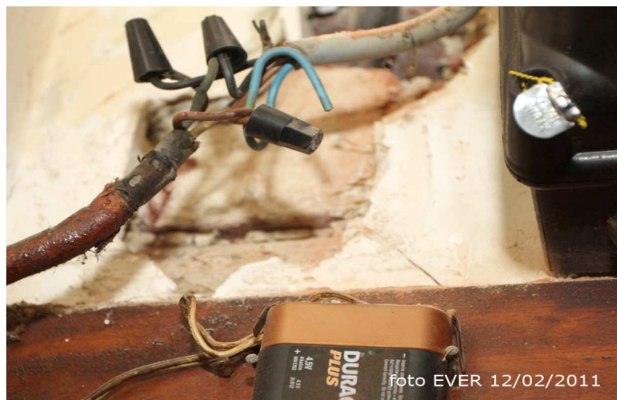
Foto van de kabellas voedingskabel zonder lasdoos, onderaan de foto de batterij voor de deurbel.
