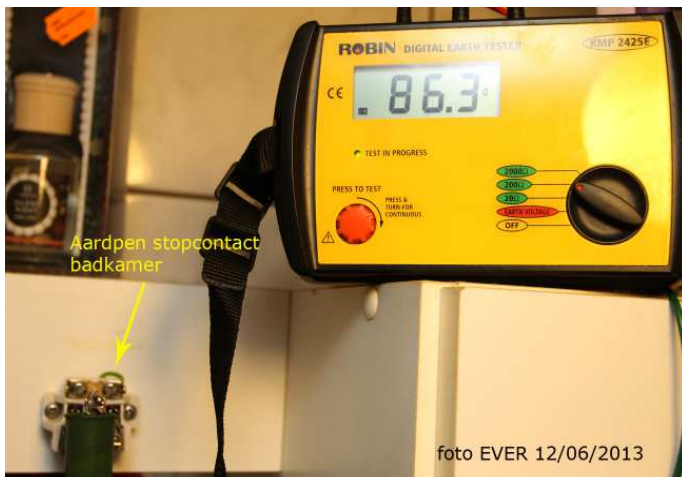
De spreidingsweerstand van de aarding aan de aardpen van het stopcontact in de badkamer was 86,3 Ohm en dat mag maximum 30 Ohm zijn, maar dat heeft Wonen Vlaanderen niet gezien!
