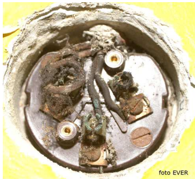
Foto van een lasdoos van de elektrische installatie van het huurpand. Bedrading nog met katoen vynil kabels geplaatst in metalen pechelbuisen die de isolatie omzeep hielpen.
