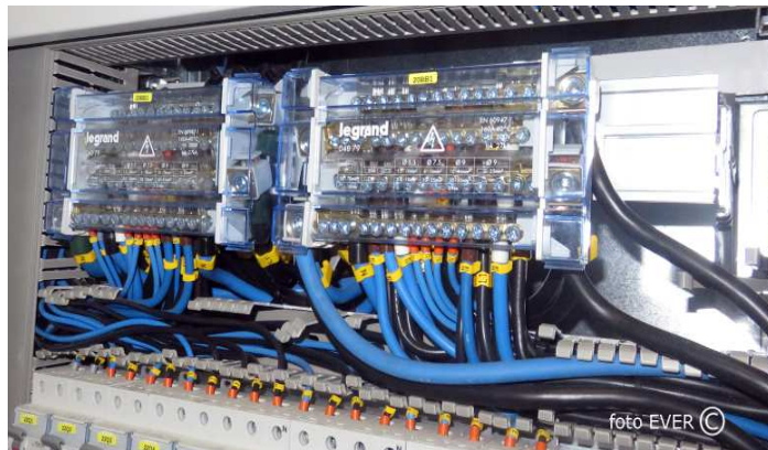
Bekabeling van hoofdbord die nooit een positieve keuring kan doorstaan, er zijn onder meer voor de 50 mm 2 VOBst geen aangepaste hulzen gebruikt -art. 251.05 AREI-. Er zijn met dit ALSB nog meer zaken die niet aan het AREI voldoen.
