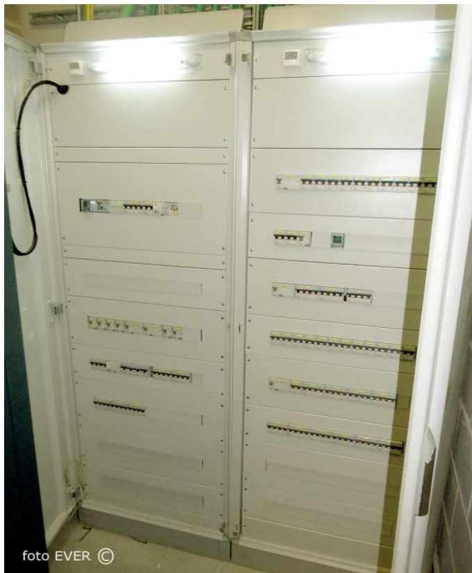
Foto 1 - ALSB bevat 23 driefasige kringen en 36 tweefasige. Het bord is gevoed met kabel van 4 x 80 mm 2 komende van de hoofdzekering van Fluvijs -toen Eandis- van 250 Ampère. Het bord zelf heeft een hoofdschakelaar van 160 Ampère. De brandweer heeft voor de erkenning door Agentschap Zorg en Gezondheid dit bord niet gezien .... toevallig is dit bord, zoals voorzien in artikel 270 van het AREI, vóór indienstelling niet gekeurd en heeft Eandis het toch in dienst gesteld !
