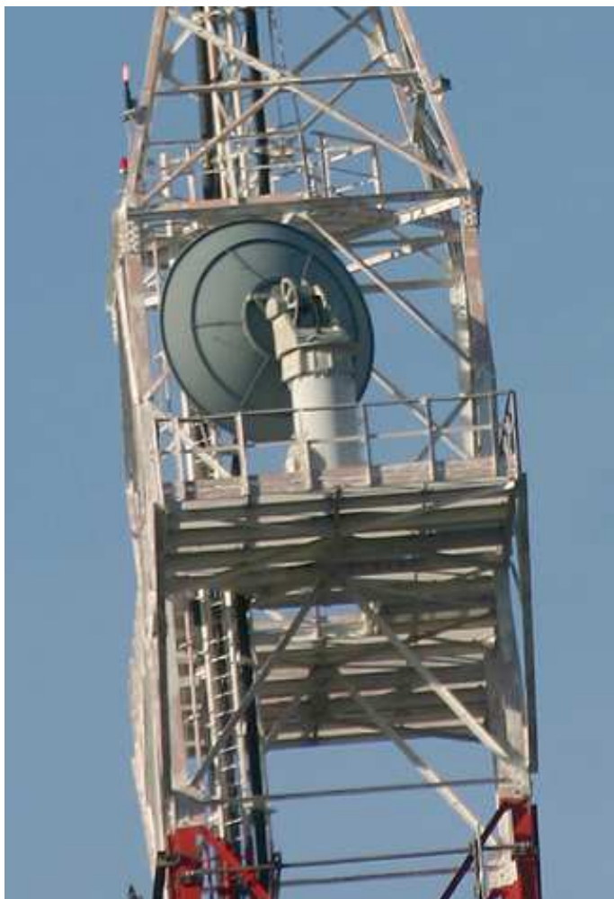
Vrt mast Genk - bordes op 150 meter hoog, tracking systeem van Orbit Israël van 850 kg - Andrew antenne van 2,40 m diameter. In 1987 door Morsum Magnificat -Erik Verbeeck- in opdracht van de BRT - mobile straaltverbindingen gerealiseerd
