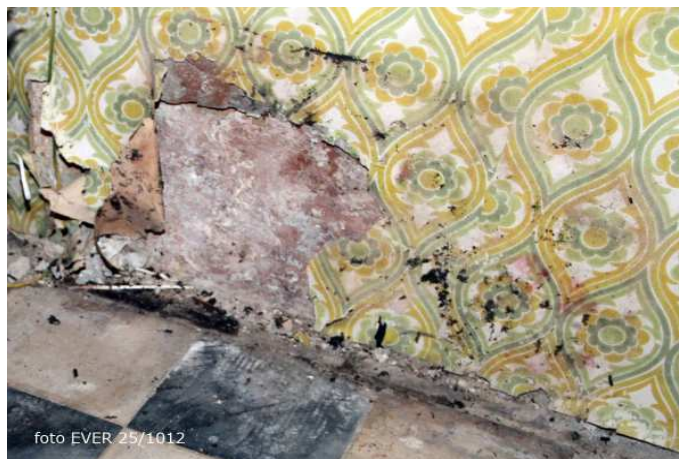
Huurwoning in Lanaken verhuurd door een op rust gesteld -Em- Arbeidsrechter, de woning kreeg 44 strafpunten van Wo- nen Vlaanderen aangemeten.
