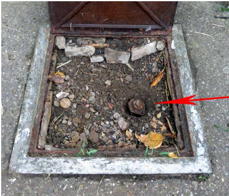
toegang tot ondergrondse tank afgedekt met puin, schroefdop totaal verroest.
