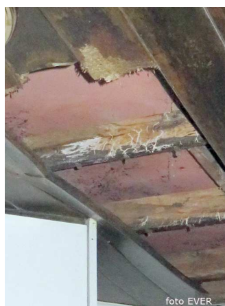
Gevolg van niet hersteld klein lek in plat dak
