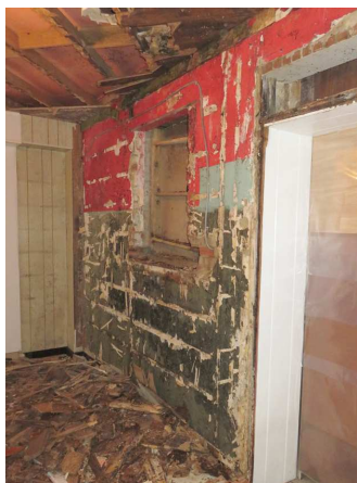
Gesloopte wanden zouden worden teruggeplaatst maar dat gebeurde niet
