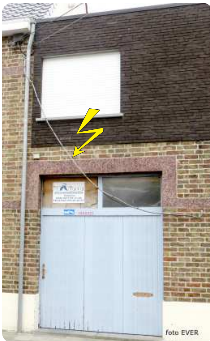
De voedingskabel is vanaf de lasdoos op de gevel nergens vastgemaakt en oefent trekkracht uit op verbindingen in de lasdoos.
