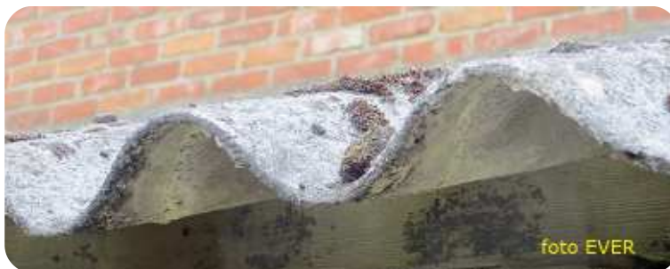
Golfsplaten uit hechtgebonden asbestcement, bij niet correcte bewerking toch gevaarlijker dan men denkt
