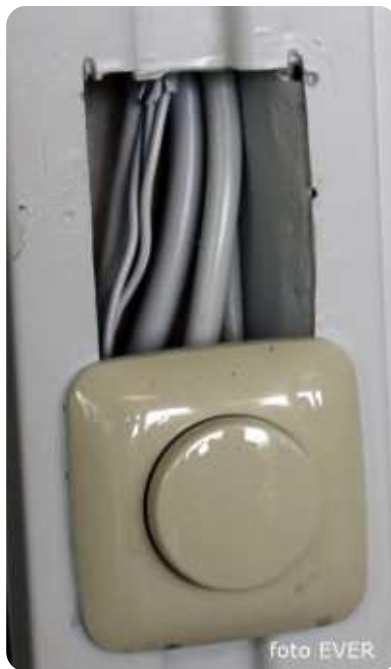
Leslokaal PLOT te Genk, toch weer een onvolkomenheid met de elektrische installatie.
