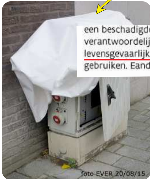
Deze elektrische installatie mag niet in dienst genomen worden. Levensgevaarlijk, zegt Eandis aan de Gouverneur.
