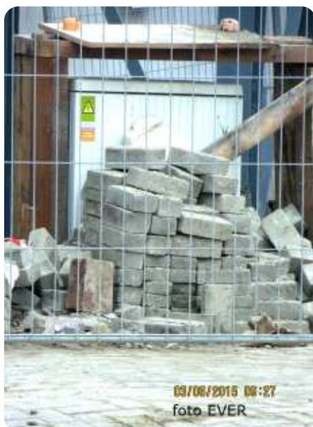
Laagspanningskast van Infracx niet meer toegankelijk.
