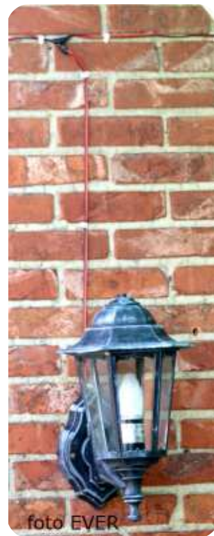
Bekabeling terrasverlichting met luidsprekerdraad geen aarding.
