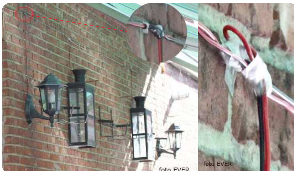
De bekabeling van de verlichting op het terras waarvan de metalen armaturen door klanten genaakbaar zijn, werd niet van een beschermingsgeleider voorzien -art. 86.04-06 AREI-. De bekabeling gebeurde met luidsprekerkabel en dat is strijdig met art. 209.02 van het AREI
