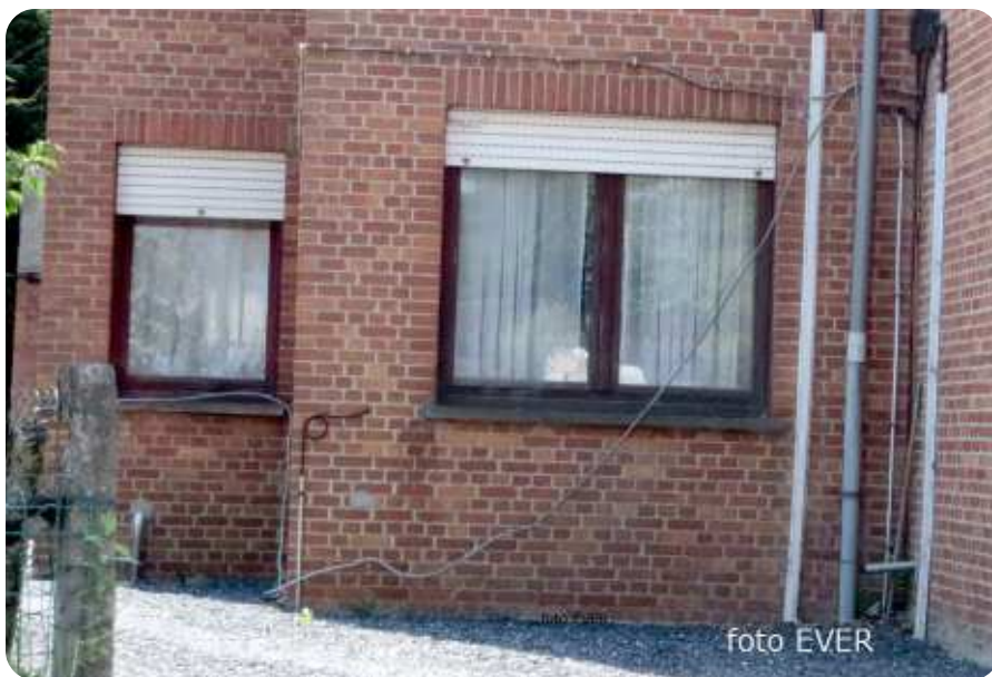
Foto 1 : Elektrische -voeding-kabel komende van het café hangt los ... dat is niet volgens de regels van het AREI -art. 143.2.e, art. 209-. Een café is een publiek lokaal en er zijn in de HoReCa al genoeg branden geweest.
