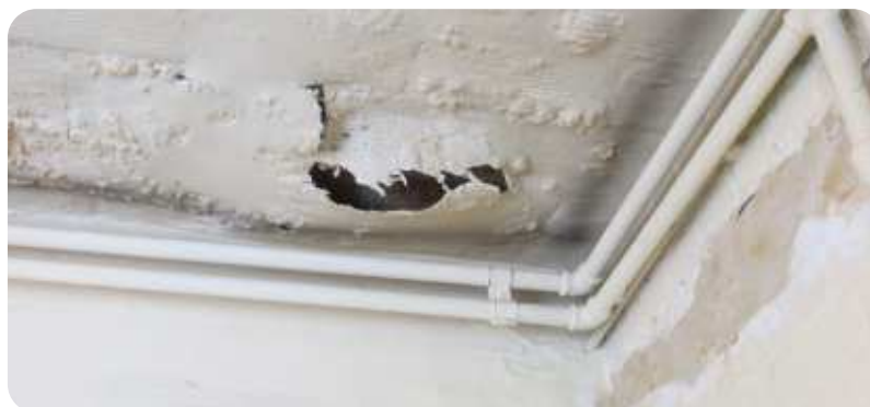
Loslatende verf wegens overal vochtige plafonds
