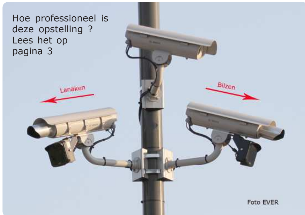
ANPR Camera's aan de Maastrichterstraat t.o.318 te Mopertingen
