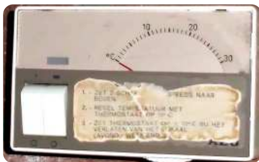
Deze thermostat die de ACEC elektrische verwarming bedient, is dertig jaar oud.
