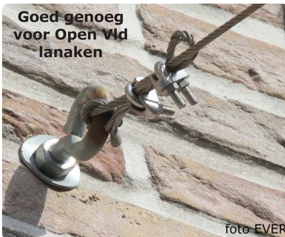
Niet conform kunst- en vliegwerk in de Stationsstraat in Lanaken
