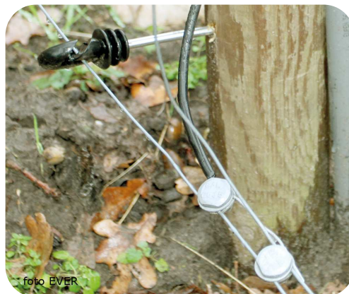
Dit is de verbinding van de spanningvoerende kabel met de schrikdraad, erg professioneel oogt dat niet.
