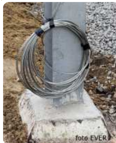
Inox kabel onderaan de paal; aanzetten tot diefstal ?
