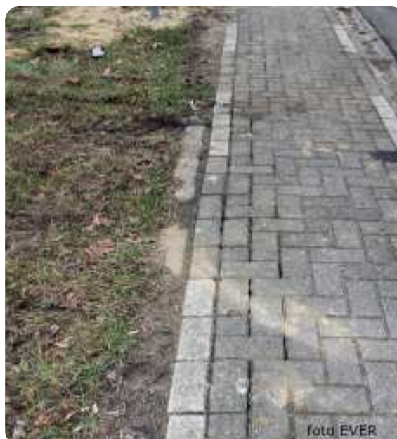
Betegeling / klinkers van fietspad beschadigd of uit verband gerukt door de machines van Stevens.
