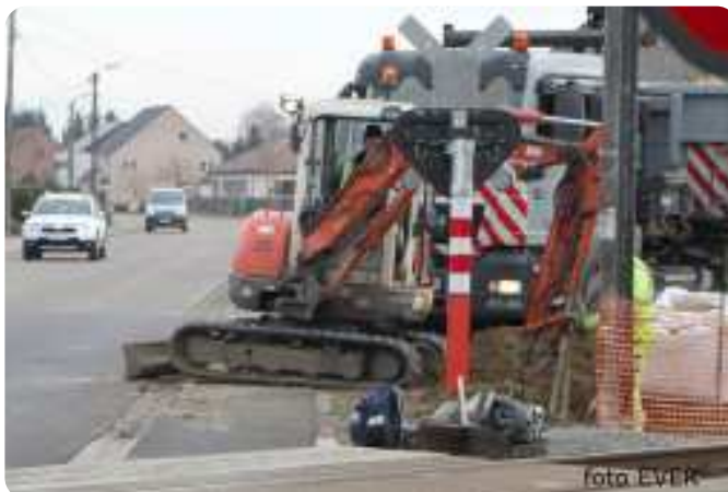
Fietspad en deel rijbaan versperd, maar er is geen enkel verkeersbord te bespeuren dat de werken aangeeft.
